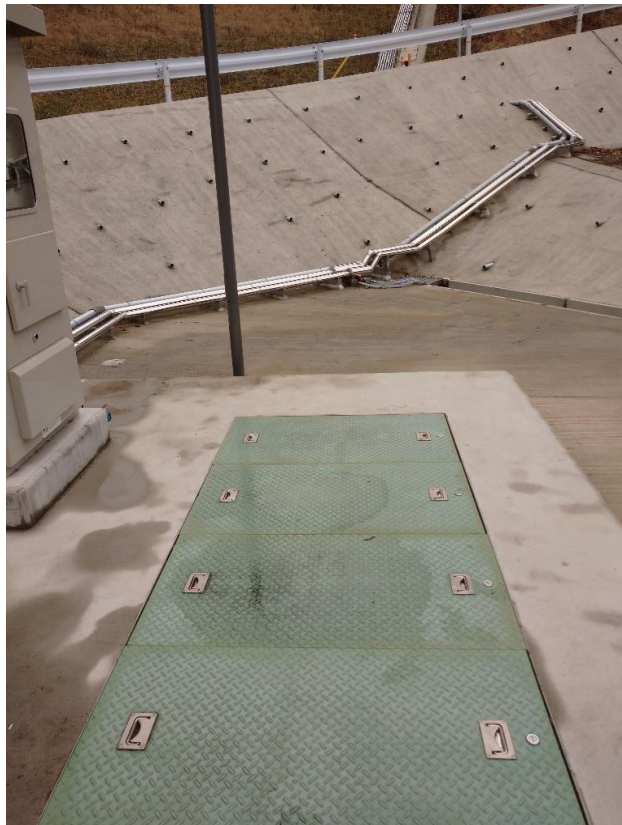
・ 浸出水バルブピット
