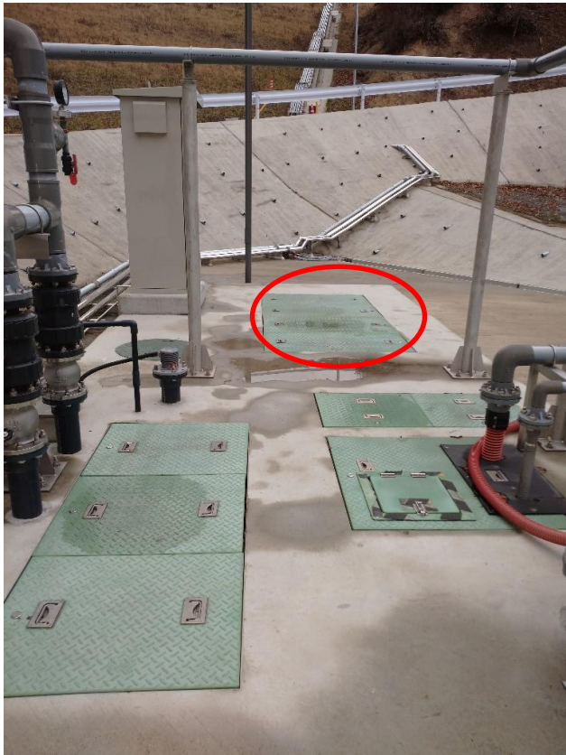
・ 浸出水バルブピット
